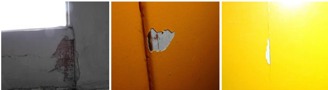
Foto 1: Versteende verflagen. Openstaande verbinding en springlagen. Scheurvorming.
