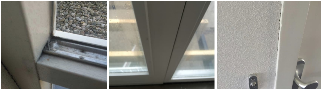
Foto 1: Lichte verschade bij verbindingen en kitvoegen
