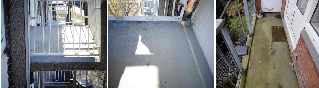
Foto 1: Coating intact, lichte vervuiling Foto 2: Coating is enigszins gesleten, redelijke vervuiling. Foto 3: Balkon zonder vloercoating, mos-en alg aangroei.
