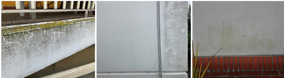
Foto 1: Diktekanen met veel mos-en alg vervuiling, verfsysteem heeft plaatselijk schade. Foto 2: Muurverflaag met structuur intact. Vervuiling. Foto 3: Algen aangroei, muurverflaag verder intact.
